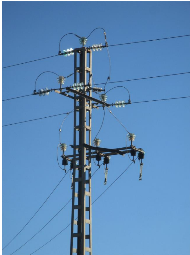
Torre de Cruceta en Cruz con Aisladores rígidos y punto derivación. (estructura más peligrosa)
