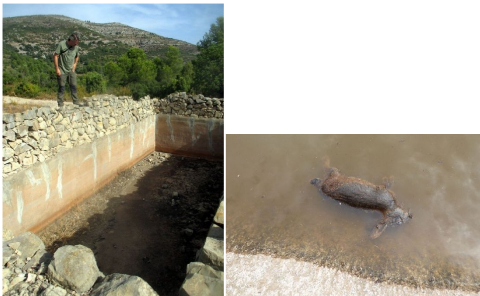
Juanlu Bort (GER) revisando balsas de riego peligrosas
