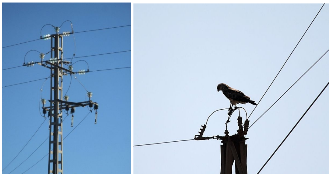
Torres más peligrosas. Tipo cruceta con aisladores rígidos, cadena de amarre y puentes por encima de la cruceta. Águila culebrera posada sobre los cables 17/08/2017
