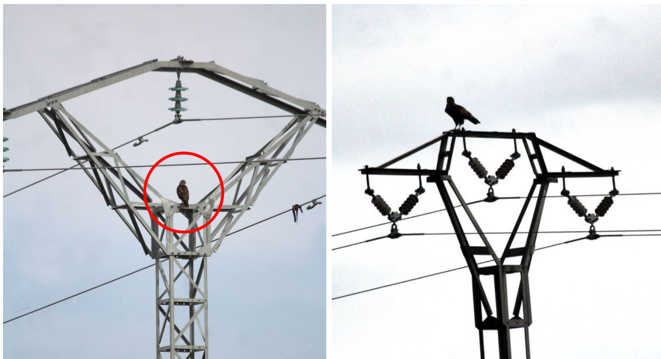
Busardos ratoneros 22/09/2017. Distintas formas de utilizar los apoyos de bóveda, más peligroso posarse dentro de la torre.
