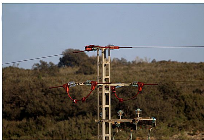
Torre de cruz con aisladores verticales y derivaciones. Torre nº CS-64462, rectificada después de 3 meses de morir el águila real..
