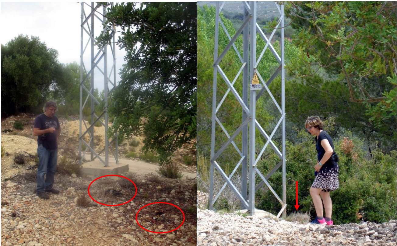
Lluís Bort y Lledó Badenes. Torre nº 190778 con 2 cuervos deteriorado. Torre nº 190782 con 1 cuervo
