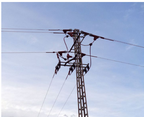
Torre de cruz con aisladores verticales y derivaciones. Torre CS 64894. Rectifica 9 meses después de localizar la primera ave muerta
