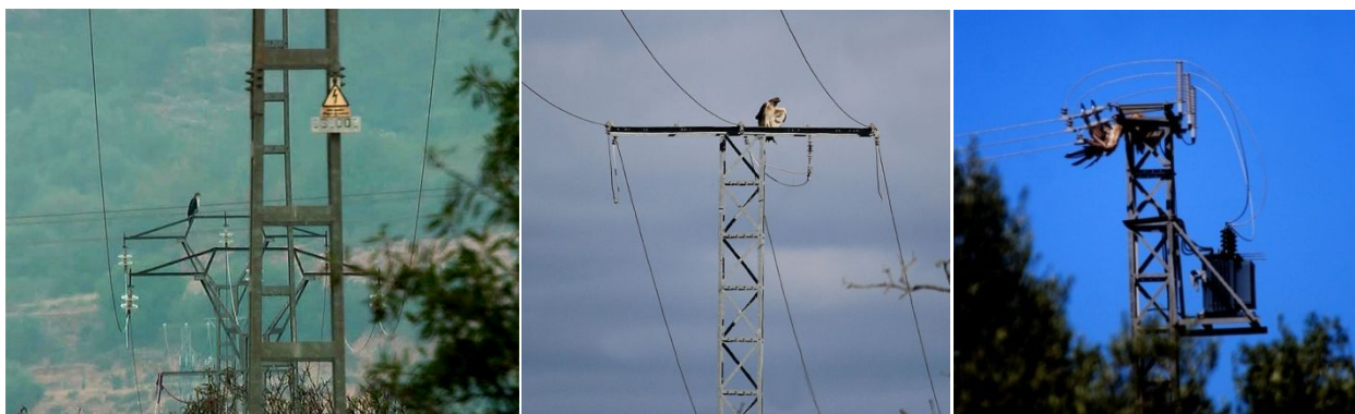
(1) izquierda forma bóveda con aisladores suspendidos, (2) centro tipo T y cadena de amarre, (3) derecha. Transformador con puentes por encima de la cruceta.
