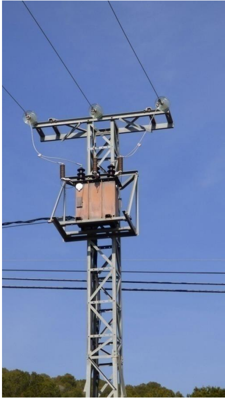
Cruceta en horizontal. Transformador.
