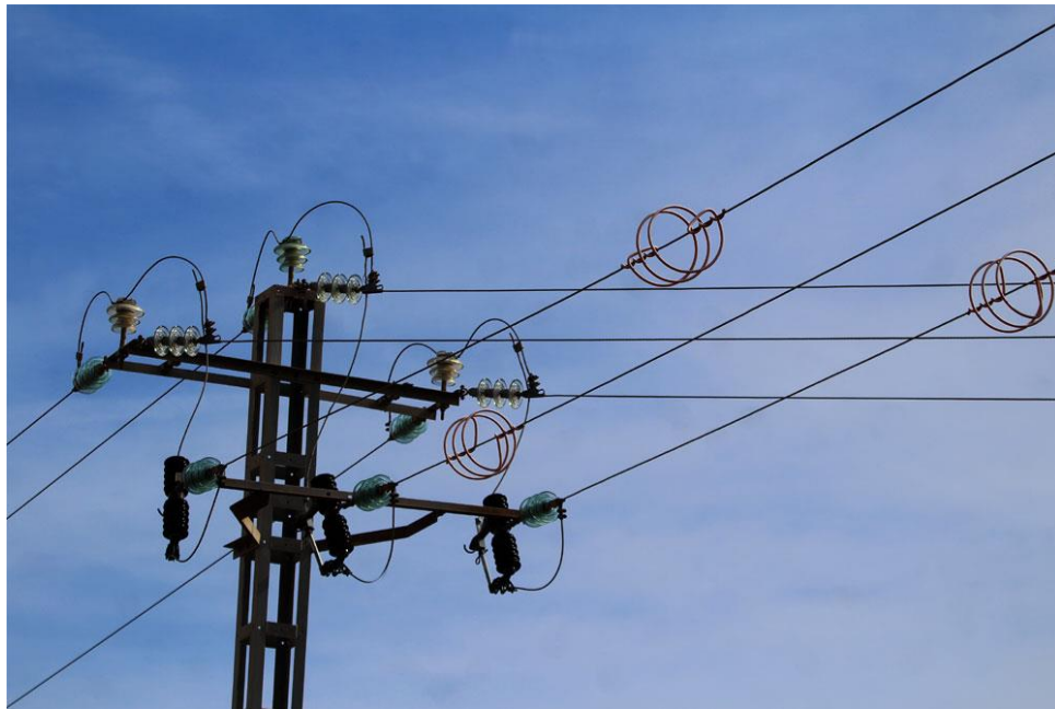
Cruceta en cruz. Aisladores rígidos (hacia arriba). Derivación. Llama la atención el cable con espirales salvapájaros
