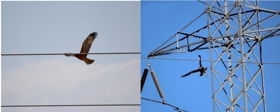
Águila-azor perdicera, cables conductores 18/08/2016
