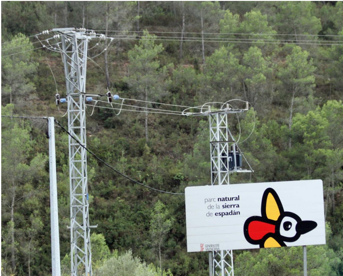
Instalación de tendido eléctrico en el desvío de Ayodar a Torralba del Pinar, sin colocar las medidas antielectrocución / anticollisión (Foto Leopoldo Pérez)
