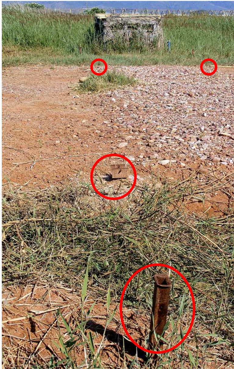
Foto: colocación de las elementos para la fijación de las redes y cuerdas
